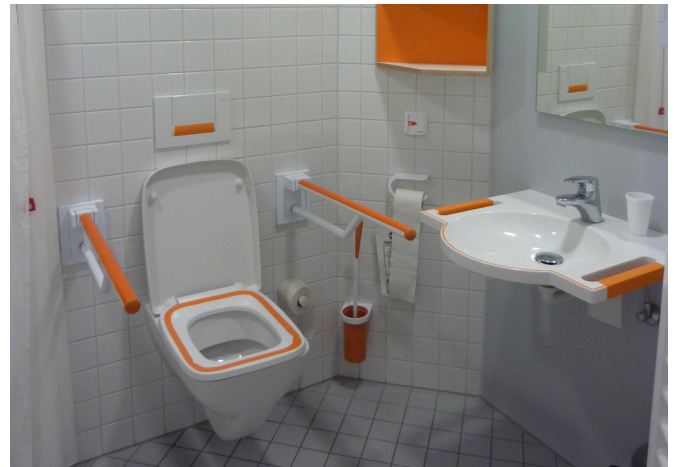
Abb. 31 Farbdifferenzierung WC und Waschbecken
