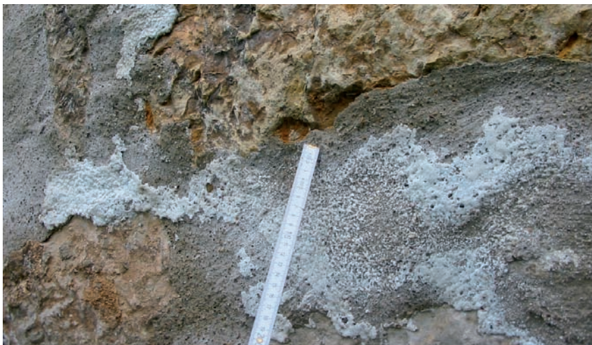
Abb. 5: Fugendetail von der Wehrmauer: Harter Zementmörtel und Ausblühungen an der Oberfläche.
