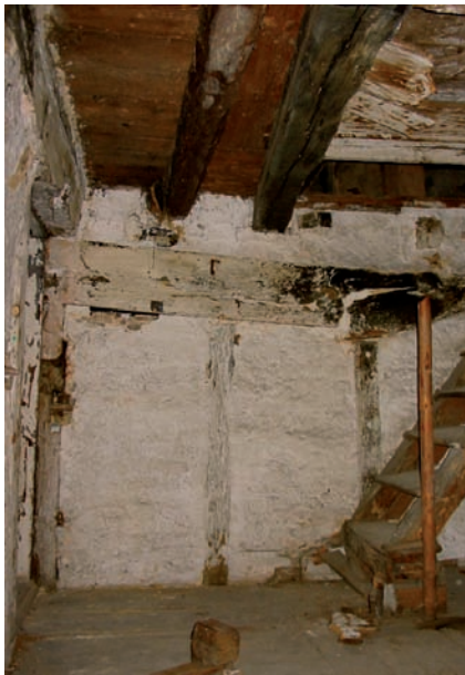
Abb. 10: Der Mittelunterzug aus der Erbauungszeit 1443 ist durchgebrochen, die Verformung in der Wand aus dem Jahr 1557 eingefroren.
