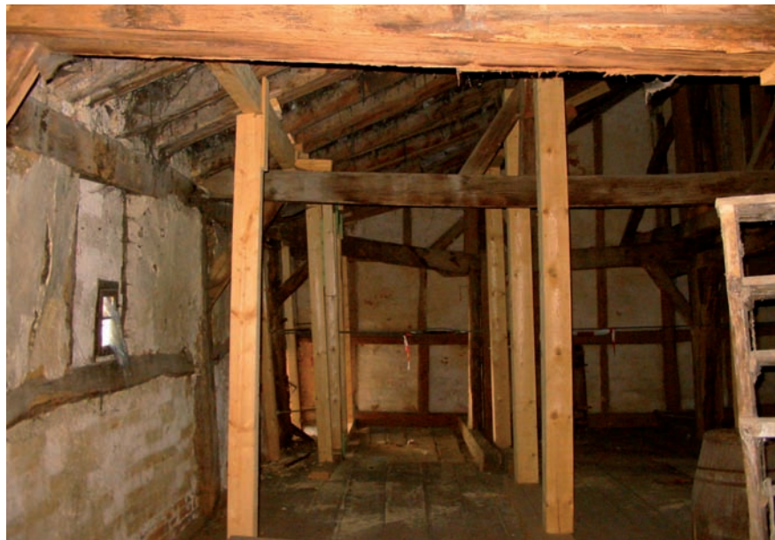
Abb. 9: Hilfsstützen im Obergeschoss, verhindern den Einsturz des schweren Daches.
