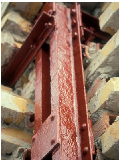
Abb. 11: Korrodierte Eisenkonstruktion im Verwaltungstrakt
