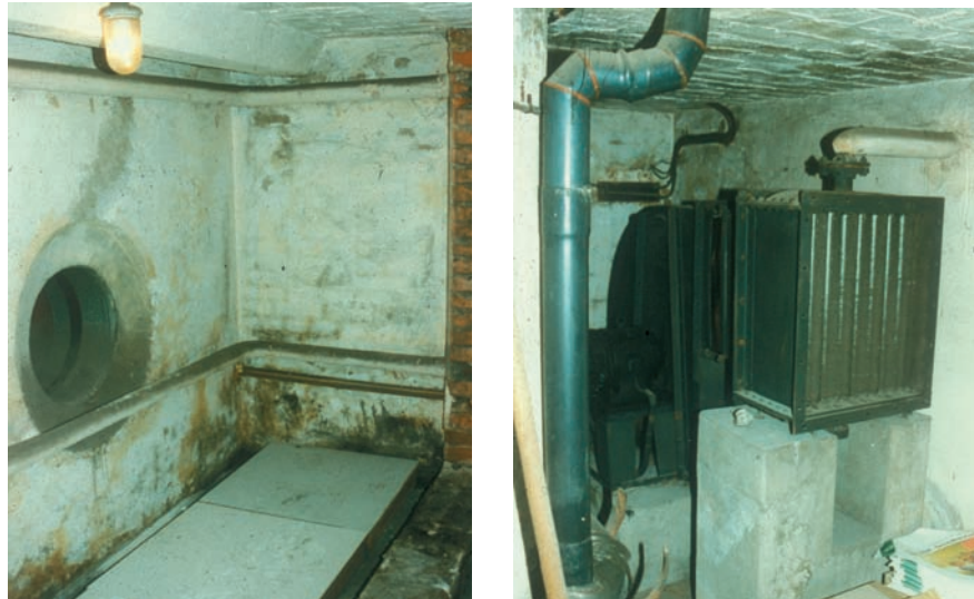
Abb. 20,21: ein Ventilator versorgt über ein Röhrensystem unter dem EG Fußboden die Innenräume mit angewärmter Frischluft
