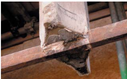
Abb. 18: Mangelhafte originale Verbleiung
