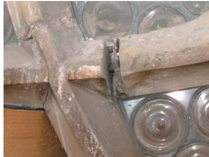
Abb. 6: Schäden im Maßwerk: gerissener Knoten, aufgegangene Fuge mit originaler Verbleiung und Dollen
