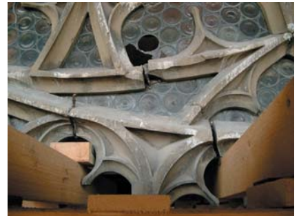
Abb. 7: Schäden im Maßwerk, oben: gegenseitige Verschiebungen und Abplatzungen, unten rechts: Bruch und Klaffung infolge Zugkraft
