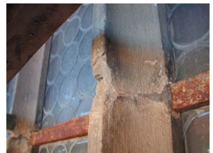
Abb. 5: Kantenabplatzung am Stab aus Sandstein
