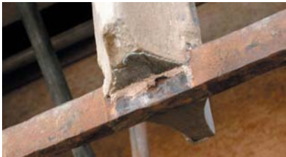
Abb. 16: Durch Kantenabplatzung beschädigter Stab mit Verbleiung
