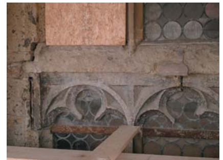
Abb. 4: Abgewitterter horizontaler Riegel mit Anschluss an Fenstergewand mit sichtbaren Klaffungen
