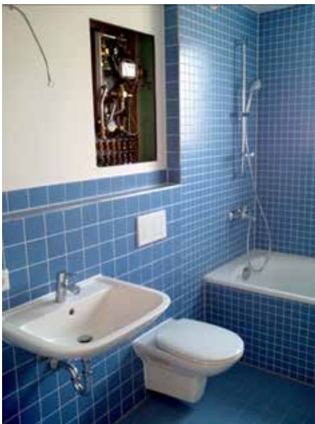
Abb. 45: Bad mit Wärmeübergabe und Frischwasserstation
